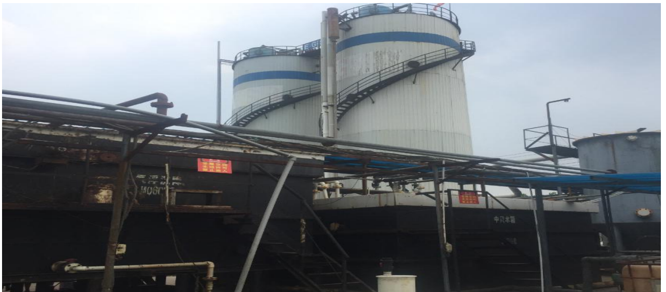
图 3.2-2 厂区污水处理站
